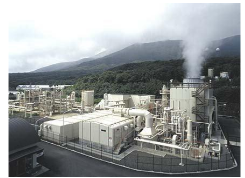
八丈島地熱発電所
