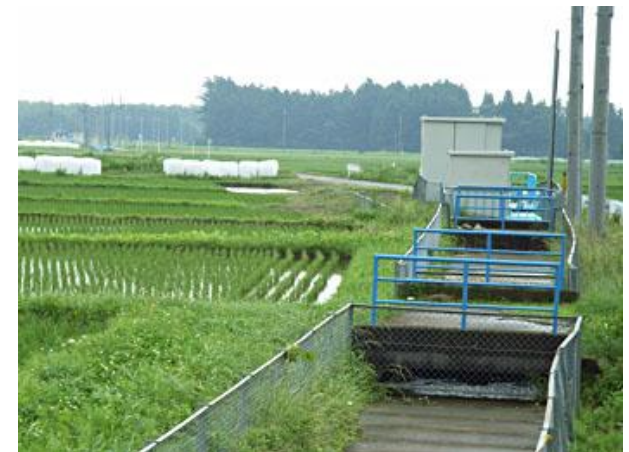
百村第一発電所
